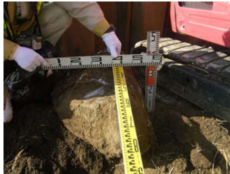
盛土中に混入されていた礫
