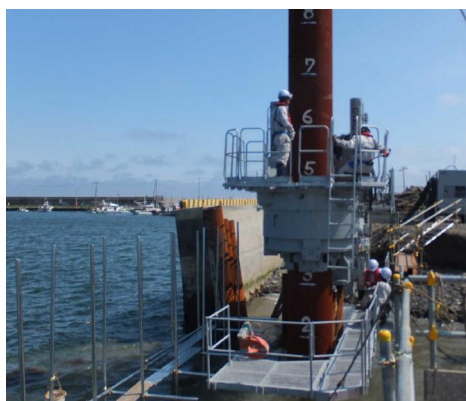
被災した既設岸壁状況
