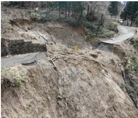
被災後（道路が崩落）
